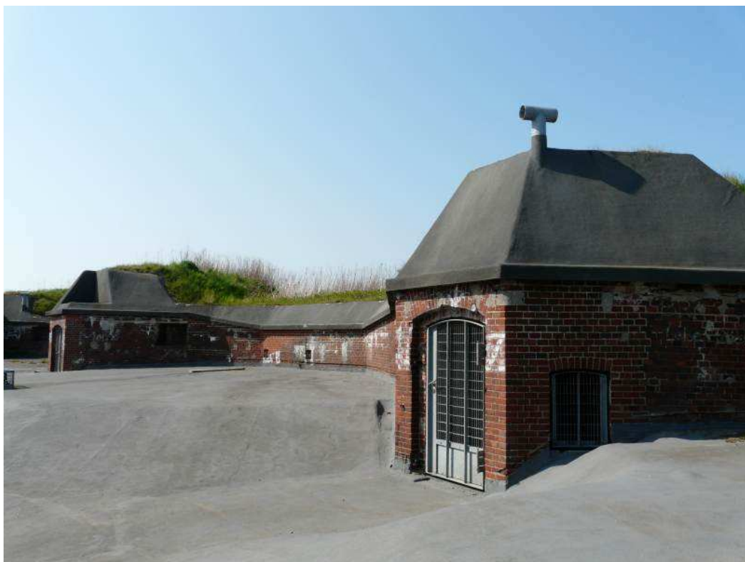
Fort Kugelbake, Würfeltraversen, dazwischen Aufstellungsfläche für Geschütz. Die graue Beschichtung wurde zur Abdichtung gegen eindringendes Wasser bei der Sanierung 1993/94 aufgebracht.
